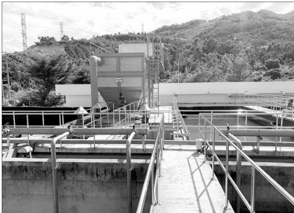
Dự án Nhà máy xử lý nước thải Khu công nghiệp Liên Chiểu - giai đoạn 2 của Công ty CP Đầu tư Sài Gòn - Đà Nẵng dự kiến vận hành từ tháng 10-2024. Ảnh: M.Q
