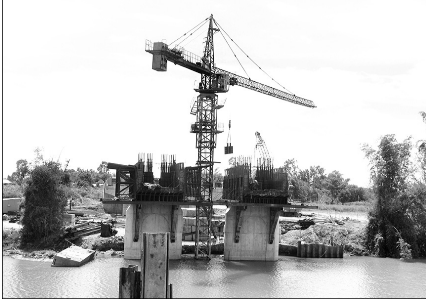
Thi công móng cầu Quảng Đà bắc qua Sông Yên. Ảnh: THÀNH LÂN
