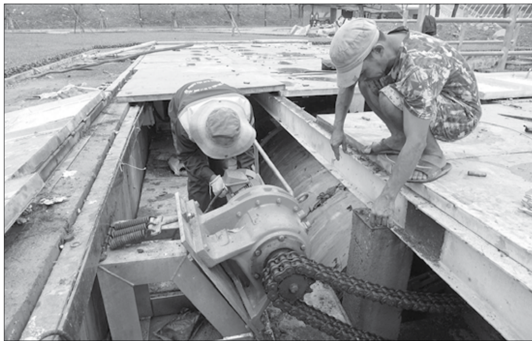
Công nhân Công ty Thoát nước và xử lý nước thải Đà Nẵng thường xuyên kiểm tra, bảo đảm vận hành các trạm bơm chống ngập. Ảnh: HOÀNG HIỆP
