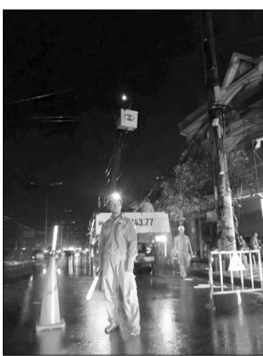
Làm việc xuyên trưa, quá tối mong sớm đóng điện cho bà con.
