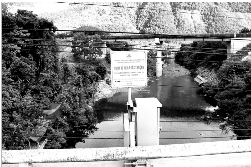
Trạm đo mực nước tự động trên sông Nam tại cầu Tà Lang - Giàn Bí đang phát huy hiệu quả trong việc cảnh báo lũ quét ở thượng nguồn sông Cu Đê và ngập lụt một số khu vực dân cư tại xã Hòa Bắc, huyện Hòa Vang. Ảnh: HOÀNG HIỆP
