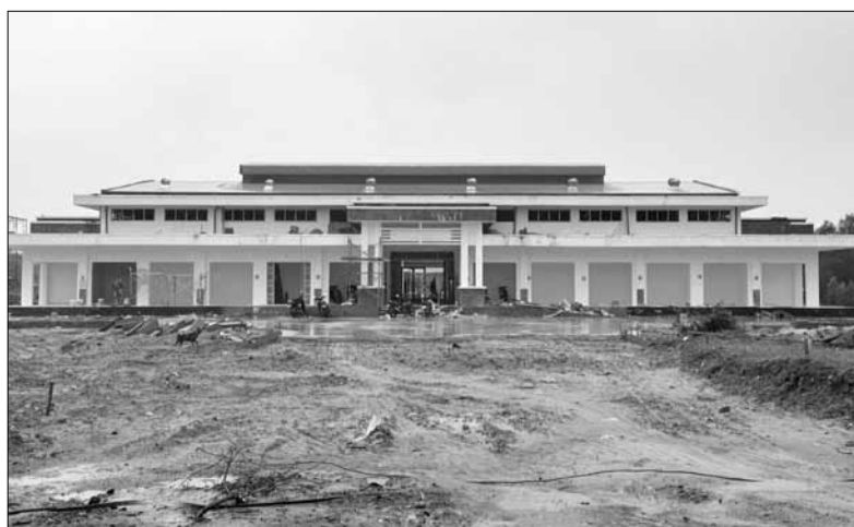
Chợ Hòa Hiệp Bắc đang được gấp rút thi công để hoàn thành, bàn giao đúng tiến độ. Ảnh: NV
