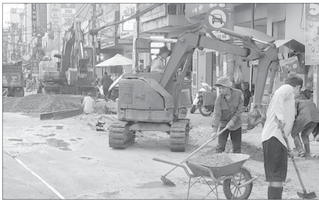
Đơn vị thi công đang nỗ lực hoàn thành các hạng mục công trình.
